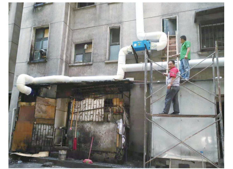
▲油烟净化装置与排烟管道安装到位 记者 李卉 摄
