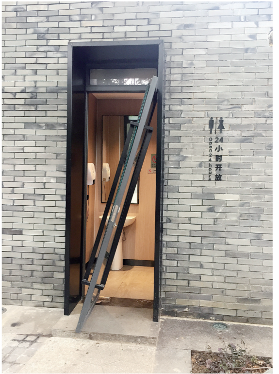
神农公园建宁驿站公厕大门被人为拆卸弃置一旁。 株洲日报记者 吴楚 通讯员/彭理 摄
