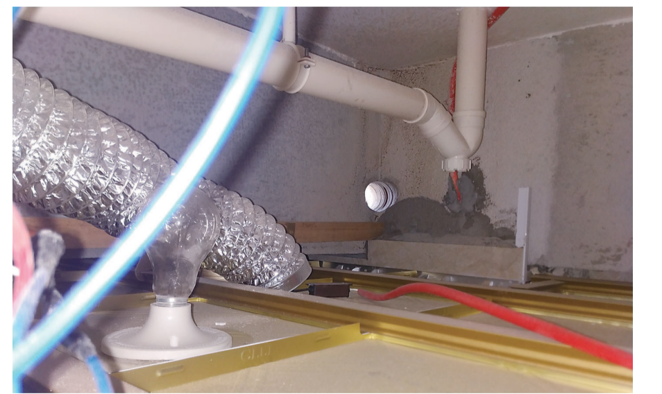
▲卫生间的废气管没有接通排气孔 记者 姚时美 摄
