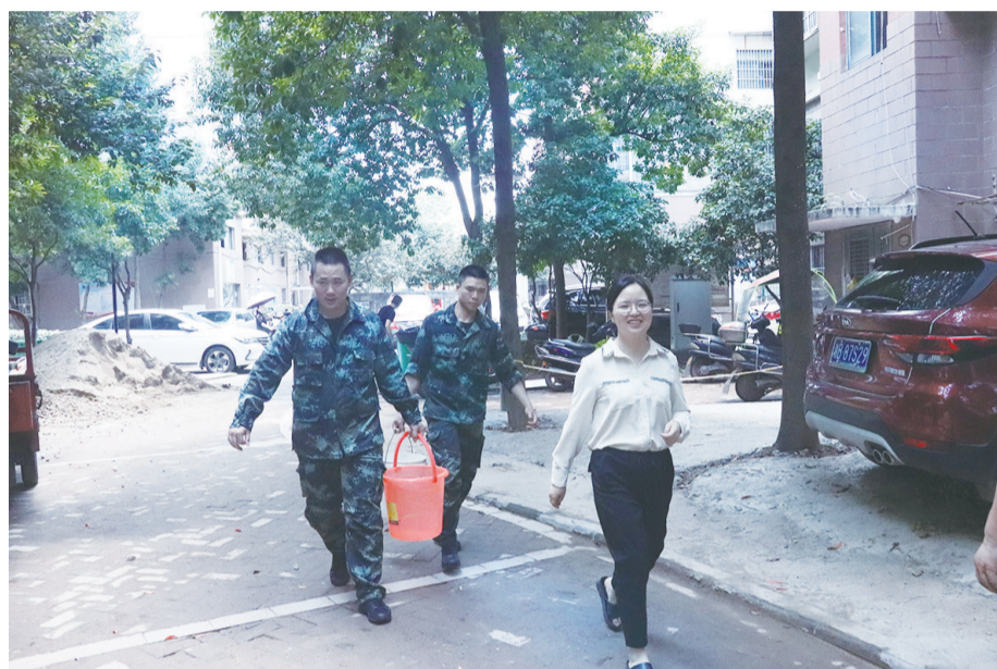
6月17日上午,天鹅湖畔小区旁的自来水管突然爆裂,导致小区停水。社区居委会工作人员向消防部门求助后,体育路消防中队的消防员驾驶消防车来到现场,打开水枪让居民接水。期间,消防员还为妇女和老人送水上门,居民们纷纷点赞。(记者 刘玺 通讯员 方圆 摄影报道)
