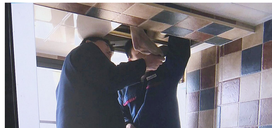
▲物业工作人员正在查看烟道漏烟情况 记者 陈驰 摄
