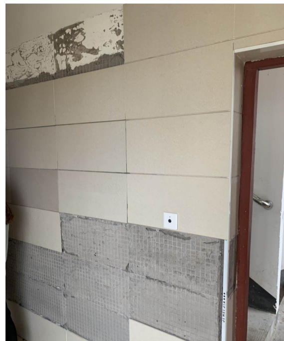
▲小区公共区域瓷片大面积脱落 记者 贺天鸿 摄
