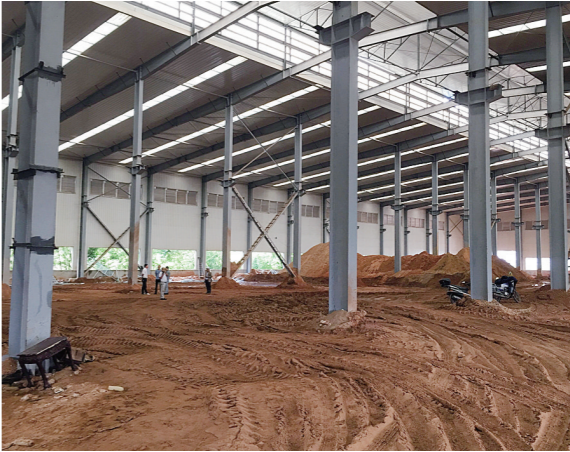
厂棚内,洗沙设备被拆除,留下几个沙土堆。刘平摄
