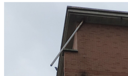
▲下水管道已经断裂,随时可能掉下来 记者 姚时美 摄
