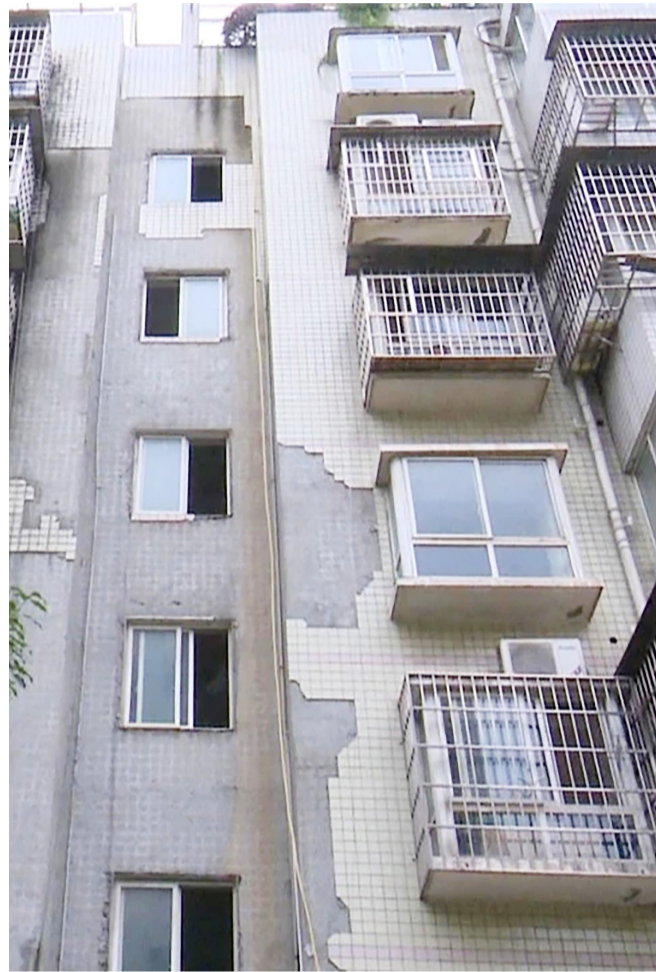
▲小区居民楼外墙瓷片大量脱落 记者 陈驰 摄
