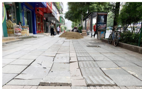
▲路面多处地砖破损,坑洼不平 记者 贺天鸿 摄
