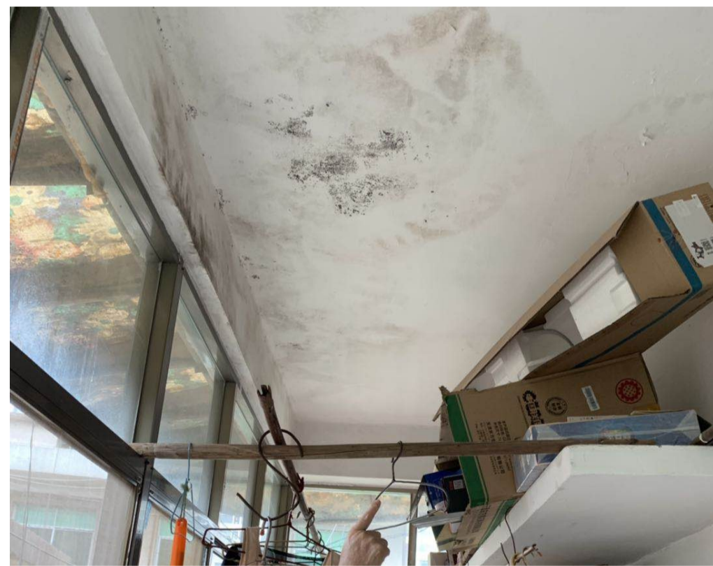
▲谭女士家阳台天花板因渗漏起了霉斑 记者 贺天鸿 摄
