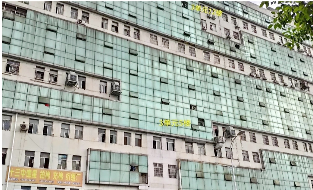
▲东华大厦多个玻璃窗存安全隐患 记者 陈驰 摄
