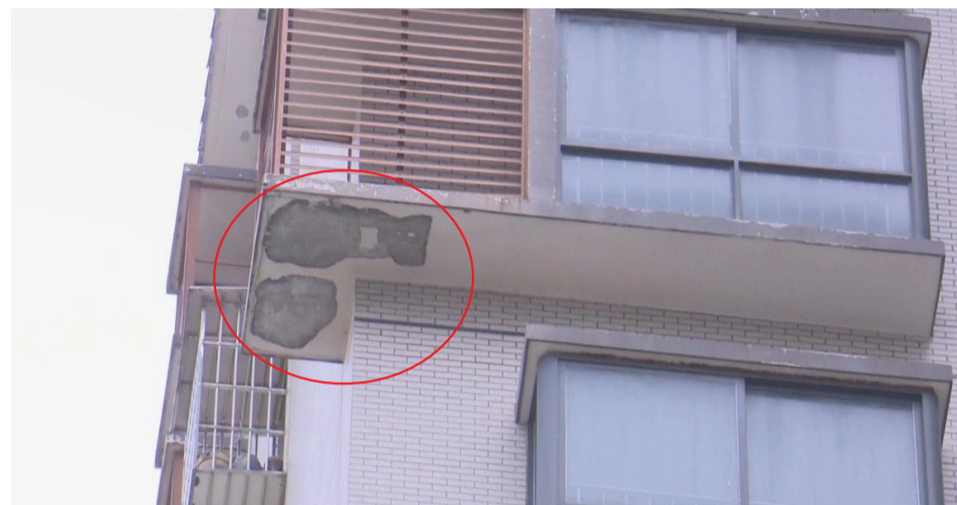
▲小区内多处有外墙瓷砖脱落的痕迹 记者 陈驰 摄
