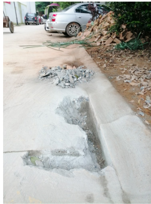
▲5月8日，医院在道路旁摆放了岗亭并破坏路基 记者 陈驰 摄
