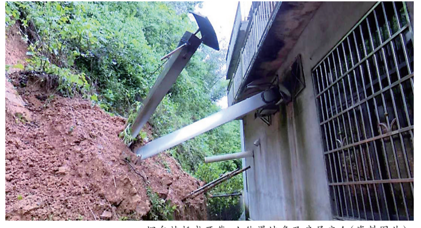
烟囱被折成两截,山体滑坡危及房屋安全(资料图片)。
