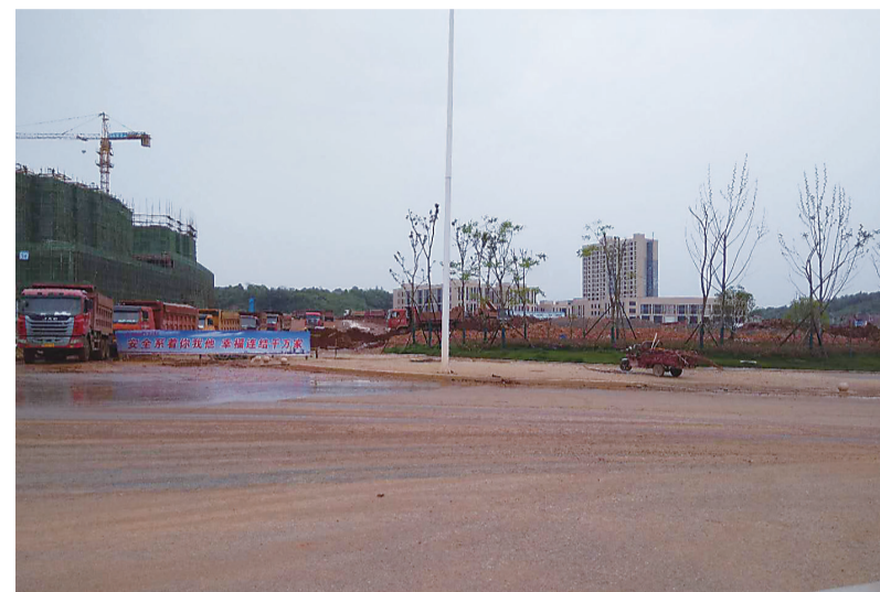
▲工地违规施工,导致路面大面积污染 通讯员供图
