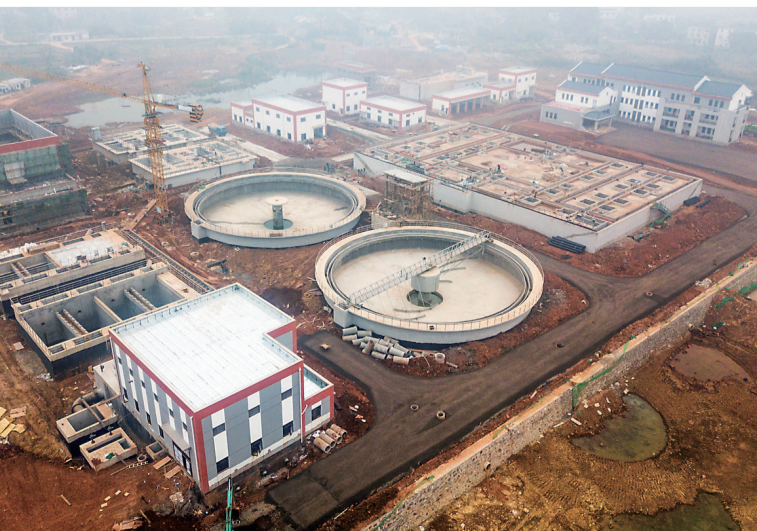
云龙示范区新建的污水处理厂。株洲日报记者 刘震摄
