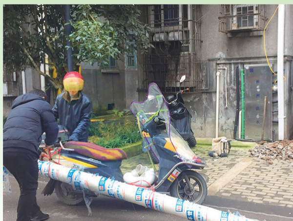
▲给居民生活造成隐患的塌陷下水管道已经被更换 通讯员供图
