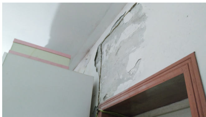
▲楼上的污水渗到楼下居民家中,泡坏墙壁 记者 姚时美 摄
