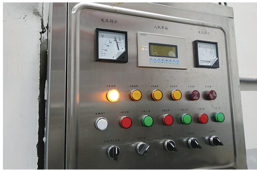
▲指示灯亮了,显示增压泵出现故障 记者 姚时美 摄
