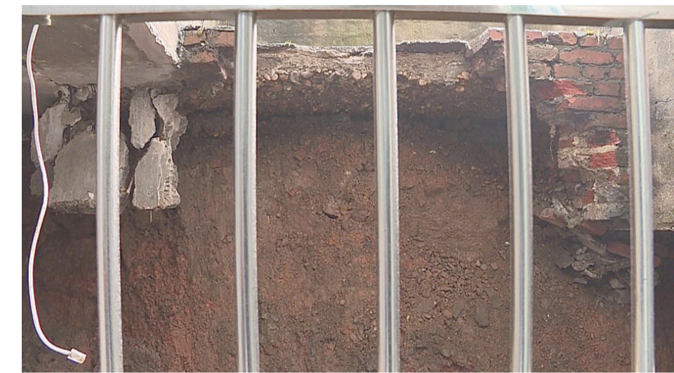
▲护坡垮塌后,唐娣驰家一楼被泥土围住 记者 陈驰 摄
