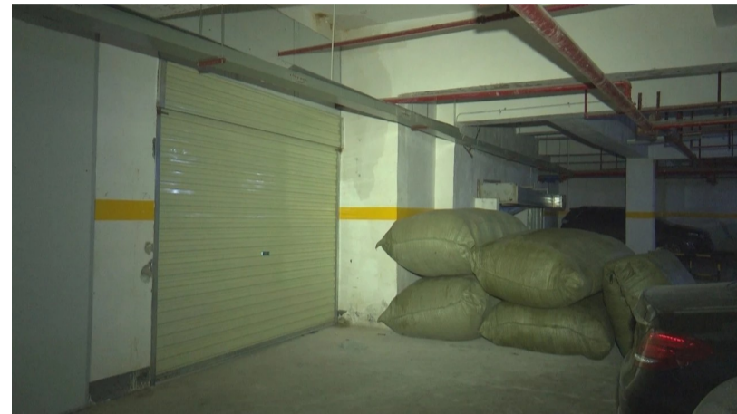
▲地下停车场部分公共区域被建成仓库，门口还摆放着货物 记者 陈驰 摄
