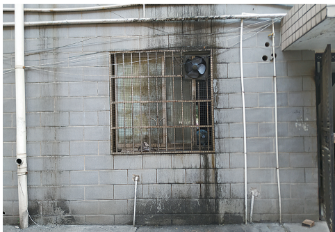
▲餐馆油烟直排,外墙满是油污 记者 姚时美 摄
