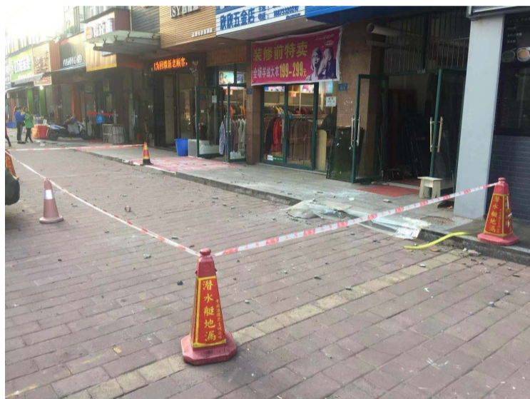
▲现场散落着许多水泥碎块 记者 贺天鸿 摄
