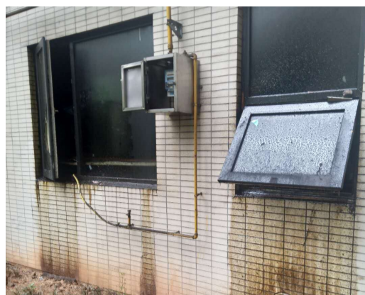
▲美的城小区,一餐馆外墙满是油污 记者 赵露 摄
