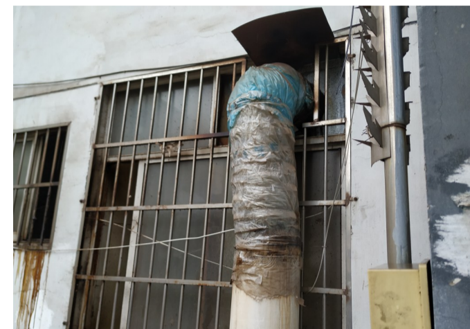
◀餐馆的排烟管道满是油污 记者 姚时美 摄
