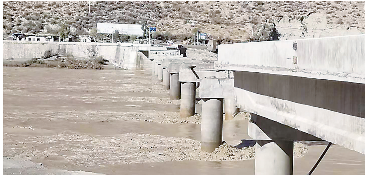
▲洪水造成大桥7跨梁板被冲毁
