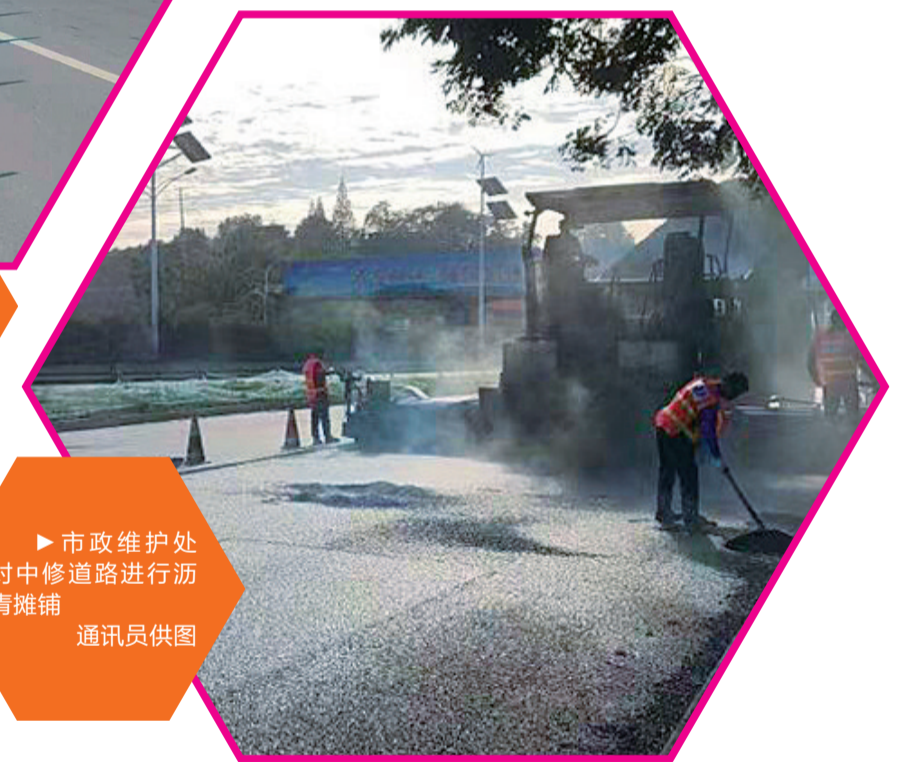
▲道路中修期间,通过设置施工提示牌、警示牌等,努力降低施工带来的交通影响 通讯员 供图
