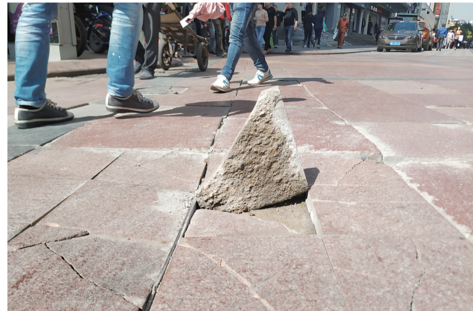
▲破损的地砖,水泥砂浆裸露在外 记者 姚时美 摄
