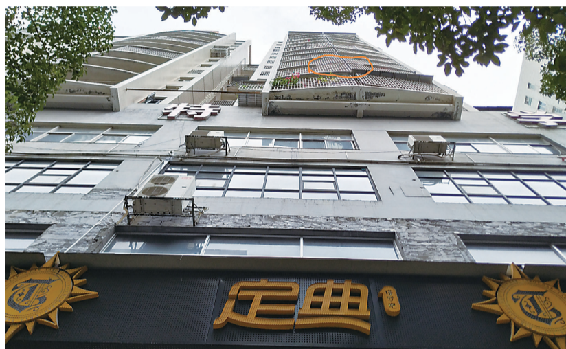
▲ 物业人员指认,去年水泥块、瓷片曾脱落砸伤人(画圈处) 记者 姚时美 摄
