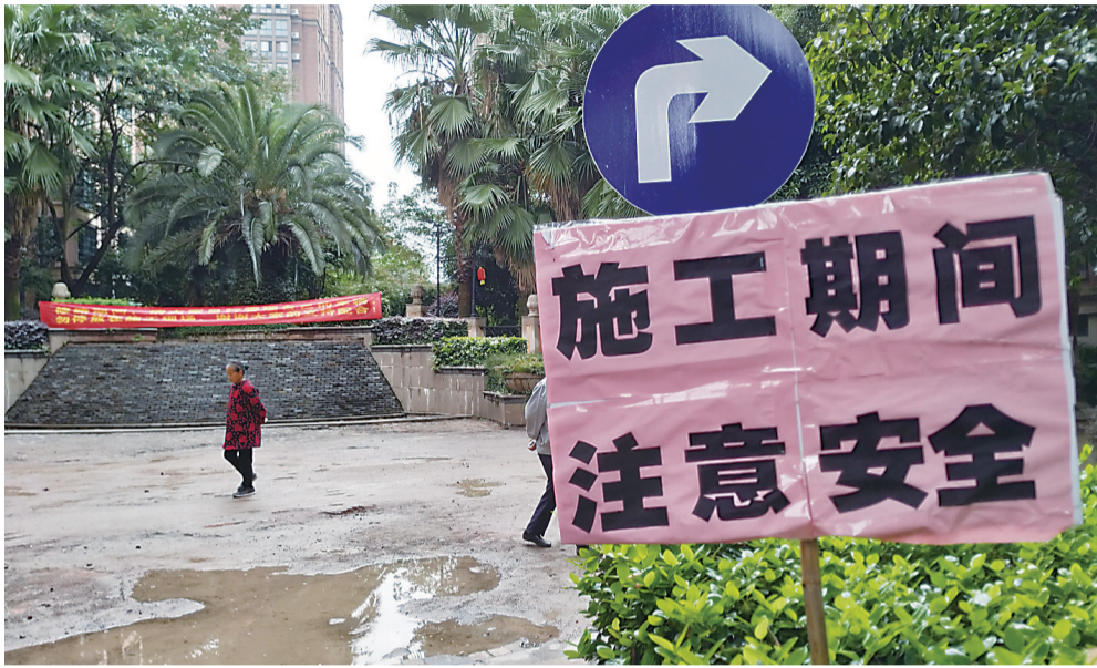
▲花好悦园小区道路挖开后停工,变得坑坑洼洼 记者 姚时美 摄
