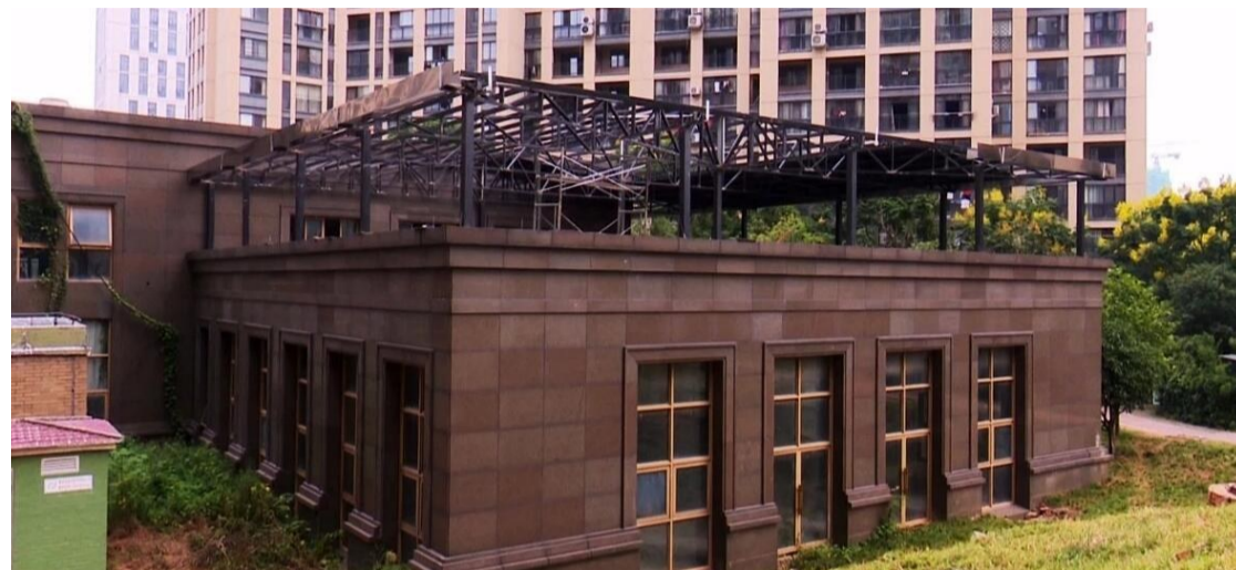
▲小区原售楼部顶楼搭建的违章建筑 记者 陈驰 摄
