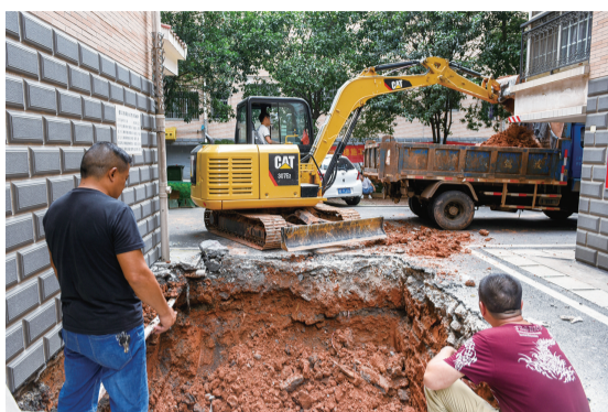
▲8月30日,在天元区神龙小区,施工人员正在清理土方,准备加装电梯
