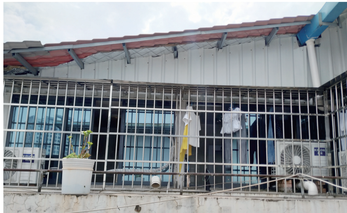
▲华茂商厦C栋楼顶违建的房屋 记者 姚时美 摄
