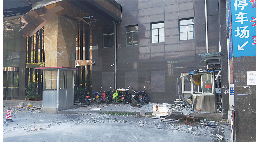
▲水泥块坠落,现场一片狼藉 记者 刘玺 摄
