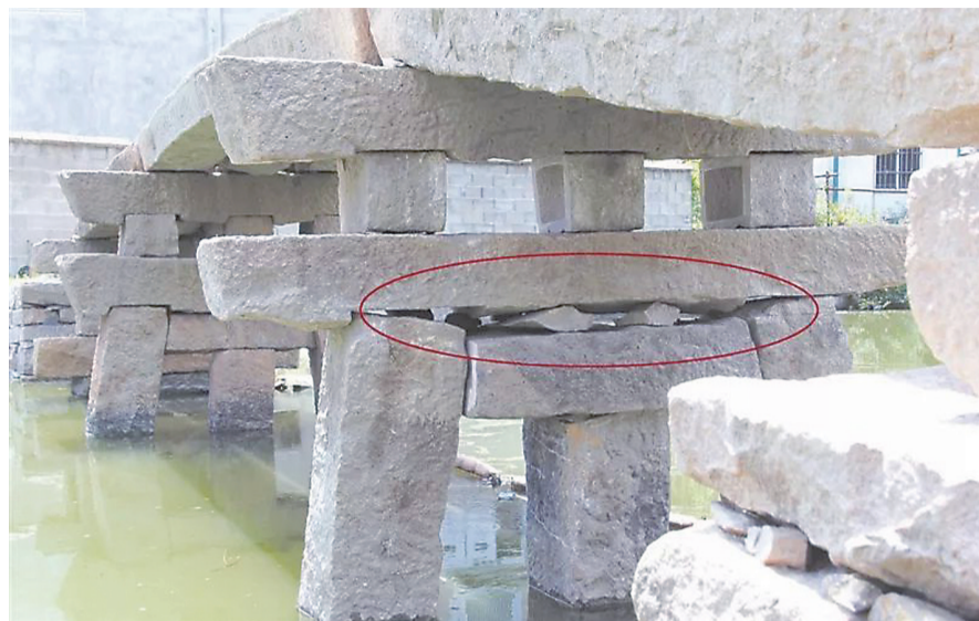
▲重修后的桥墩缝隙比较大,缝隙间用小石块进行填充
