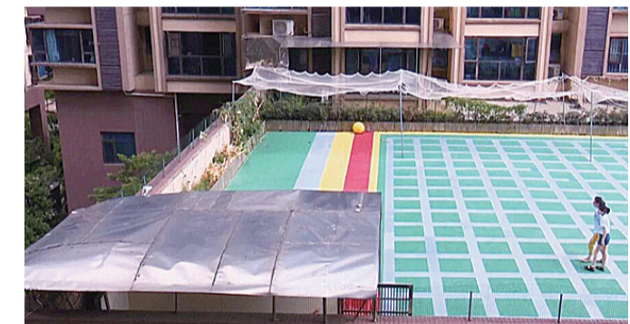
▲幼儿园在楼顶搭建的违章建筑 记者 陈驰 摄
