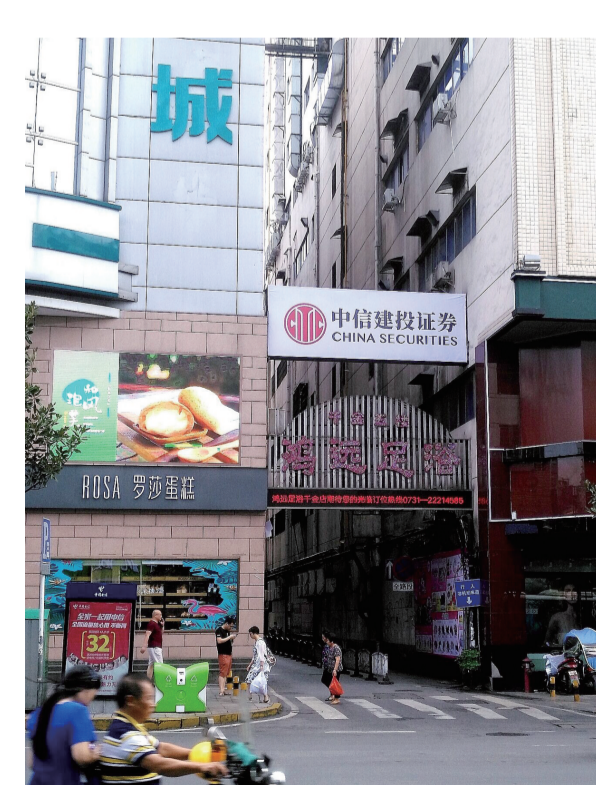
▲检查发现存在安全隐患的建筑物墙面广告 记者 伍靖雯 摄
