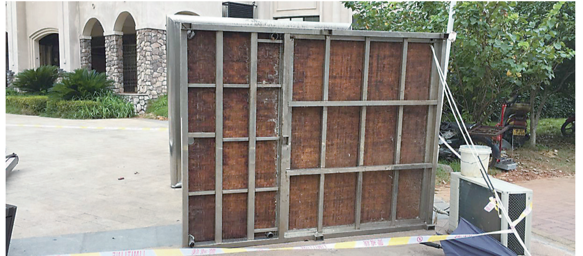
▲三一歌雅郡保安亭被掀翻在地 记者 赵露 摄
