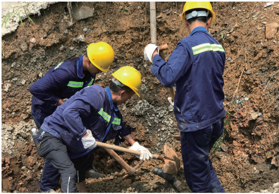
▲昨日中午,市水务集团员工在石峰区抢修输水管道 通讯员供图
