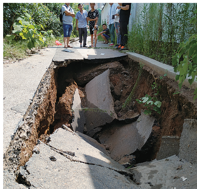
▲路面塌陷现场 记者 姚时美 摄
