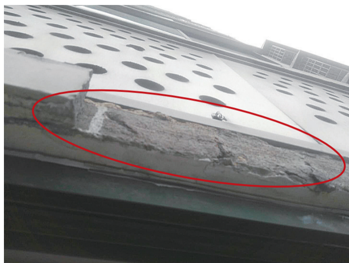
▲12楼掉落水泥块的地方 记者 成姣兰 摄
