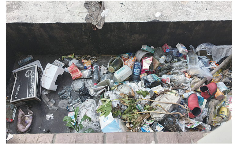
▲打牛塘安置小区一处单元门的屋檐上已成为垃圾堆 记者 戴凛 摄
