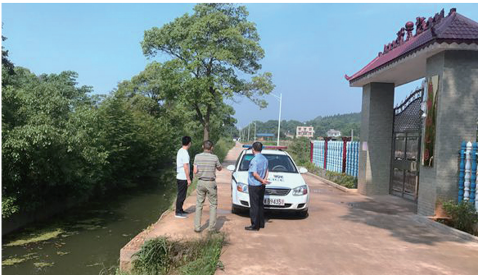
▲幼儿园门前的路很窄,水渠也没有装护栏,存在安全隐患 通讯员 许琳 摄
