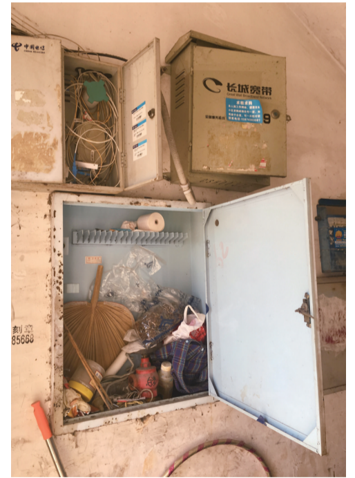
▲恒丰小区内多处消防设施已不见踪影 记者 戴凜 摄
