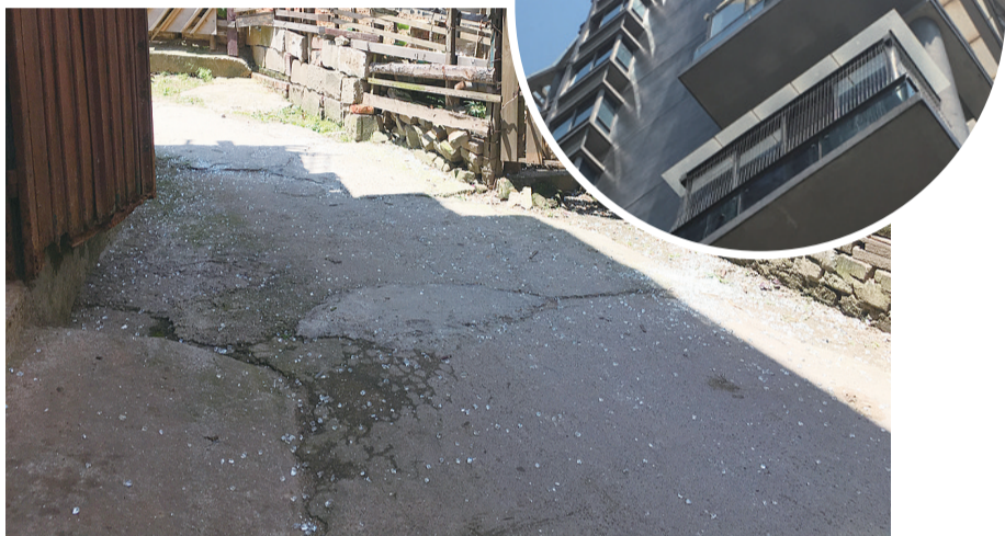
▲刘媵驰家门口,玻璃碴散落一地(大图)。5楼的阳台钢化玻璃部分缺失(右上小图) 记者 成姣兰 摄
