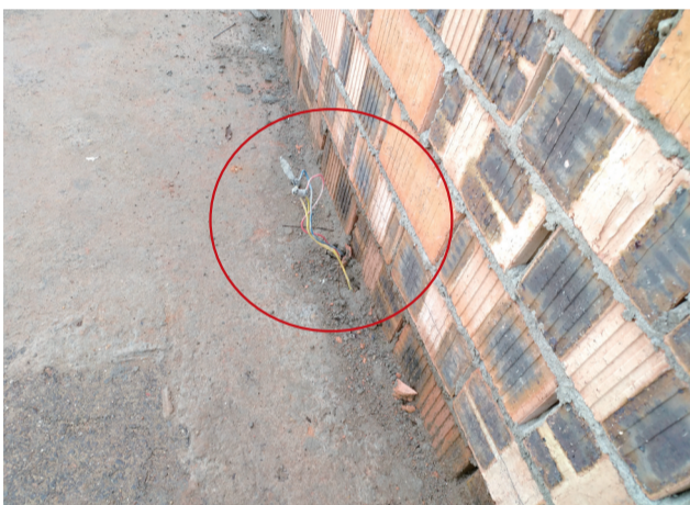
▲路灯被挖掉,新砌的围墙下露出一截电线 记者 姚时美 摄
