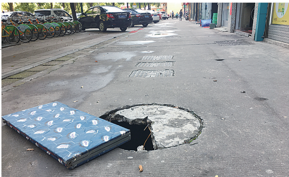
▲井盖已缺损一半,露出钢筋 记者 成姝兰 摄
