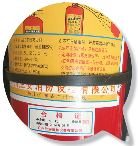
▲8栋楼道间的过期灭火器 记者 贺天鸿 摄
