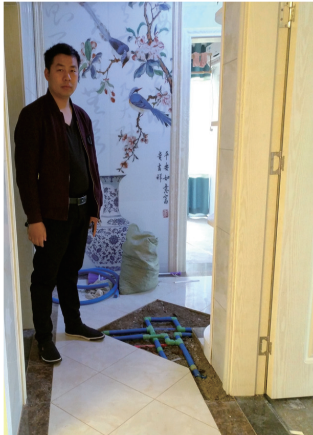
▲走廊被撬开的地方是一个漏点,已修复 记者 姚时美 摄
