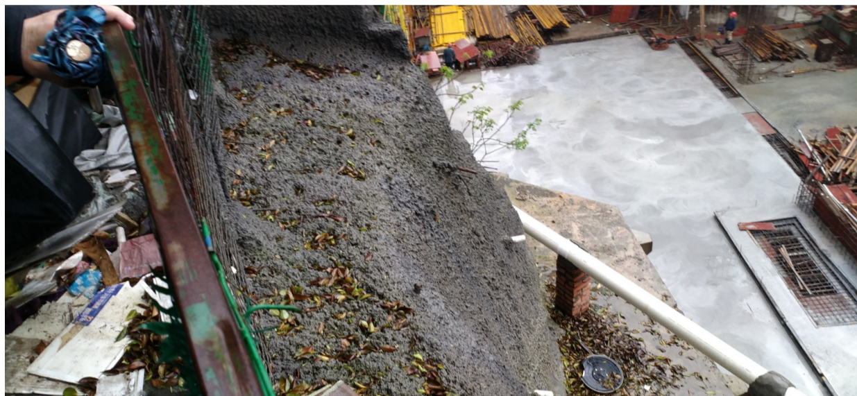
▲消防通道被挖断,断面铺上了水泥,形成一处“悬崖” 记者 姚时美 摄
