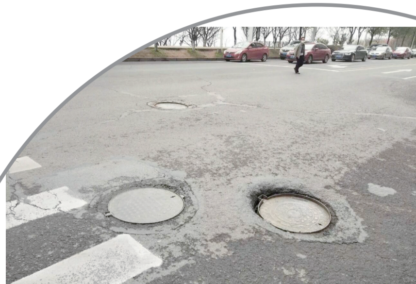
▲路面多个井盖出现破损 记者 陈驰 摄
